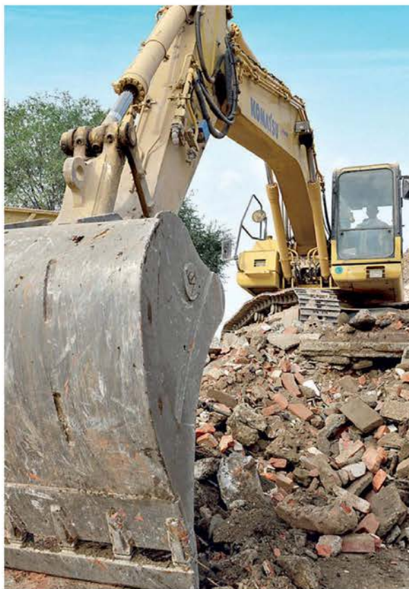
Allarme sicurezza nei cantieri edili
